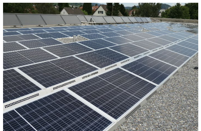
Die total 162 Photovoltaik-Panels können von Kundinnen und Kunden der Regionalwerke AG Baden und der Elektrizität Wasser Neuenhof ewn gebucht werden. Im Gegenzug wird eine jährliche Energiegutschrift von 290 kWh ausgewiesen.
