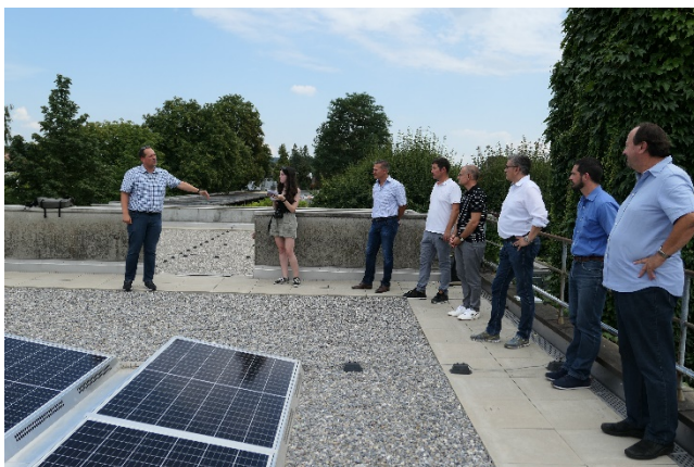
Besichtigung der dritten miinSTROM-Anlage auf dem Dach des Terrassenbads. Michael Kammerlander, Projektleiter, Regionalwerke AG (links) erläutert den Aufbau der Photovoltaikanlage.
